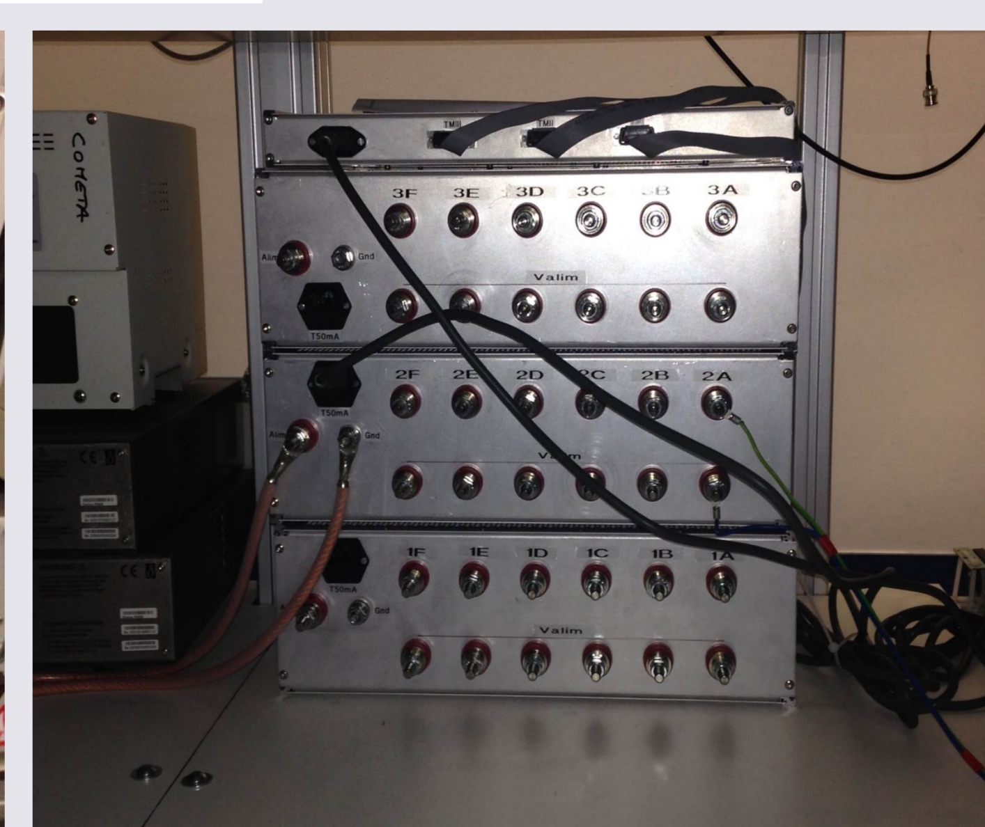
La partie puissance en face arrière (connections des bobines sur traversées isolantes 100A-1000V)
