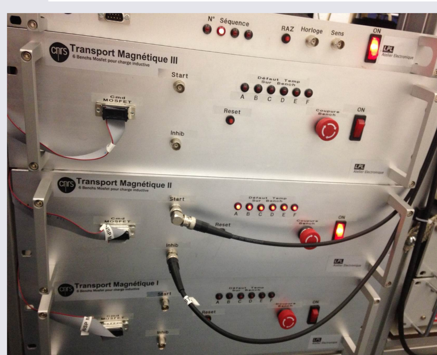
châssis décodeur-séquenceur en haut Les trois châssis de puissance en bas
